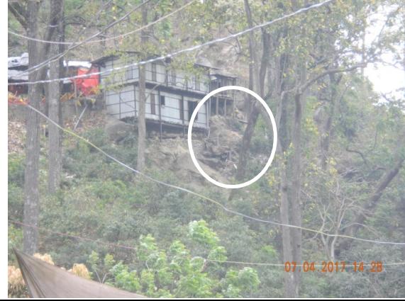
One more structure on the edge, the encircled portion shows stepping drain pipes emptying onto the slope किनारे पर एक और भवन, सफ़ेद गोला पानी निकासी की सिड्डीनुमा पाइप दर्शा रहा है
